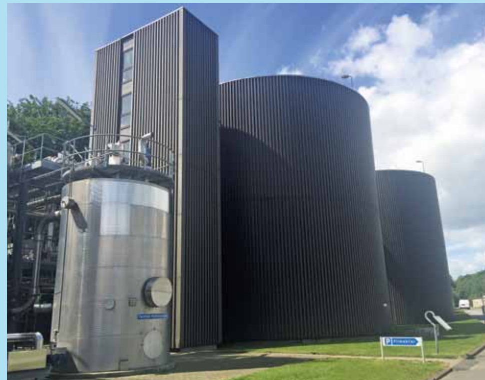
Slammet opvarmes først i hydrolyseanlægget (forrest) og pumpes videre til de to rådnetårne, hvor der produceres biogas af slammet.
